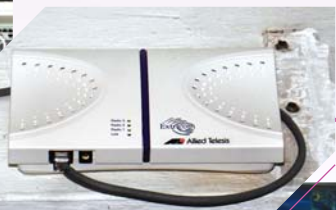
戶內操場安裝了多個Wi-Fi無線發射台。
